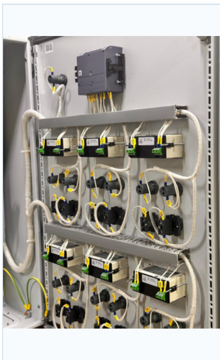
Distribución del cableado en la puerta del tablero.
