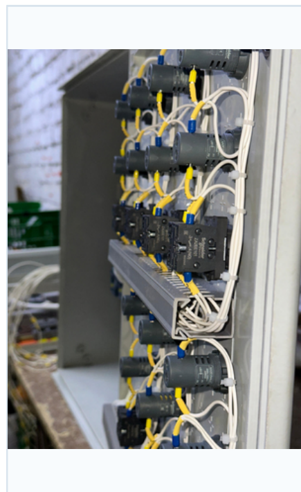
Salida de conductores hacia los componentes.
